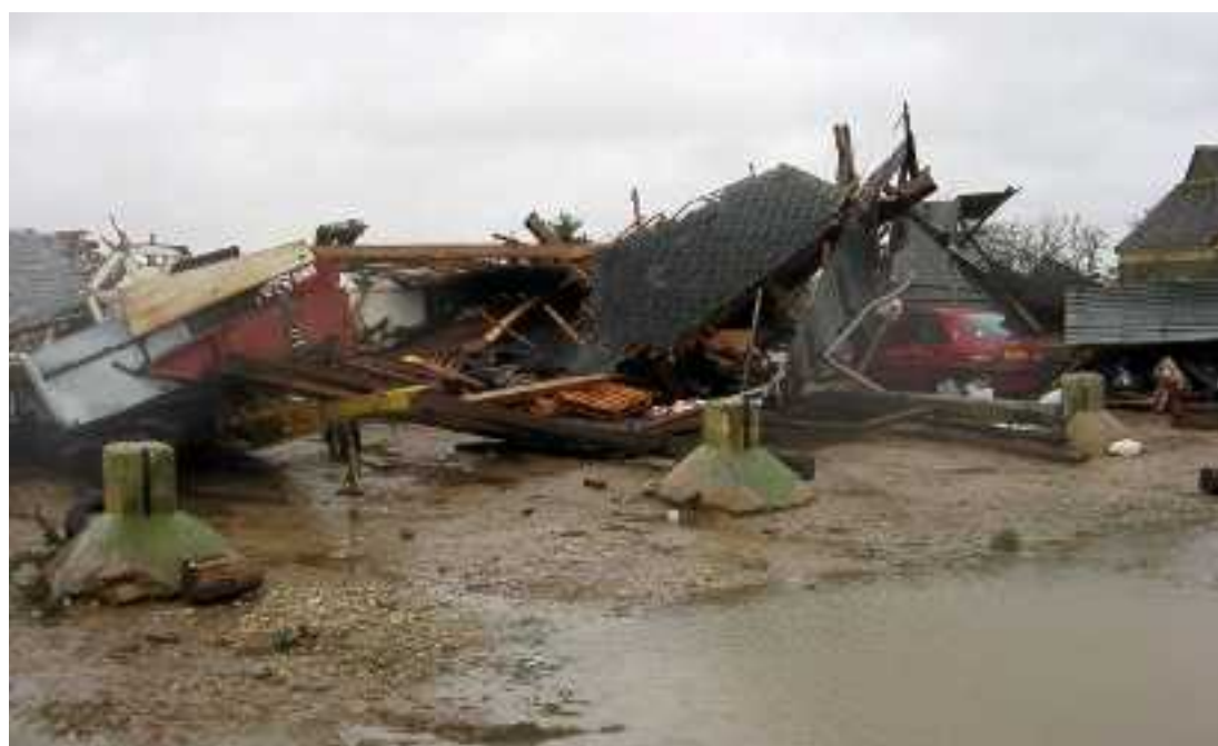
Le hangar s'est écroulé sur une voiture et une caravane.
