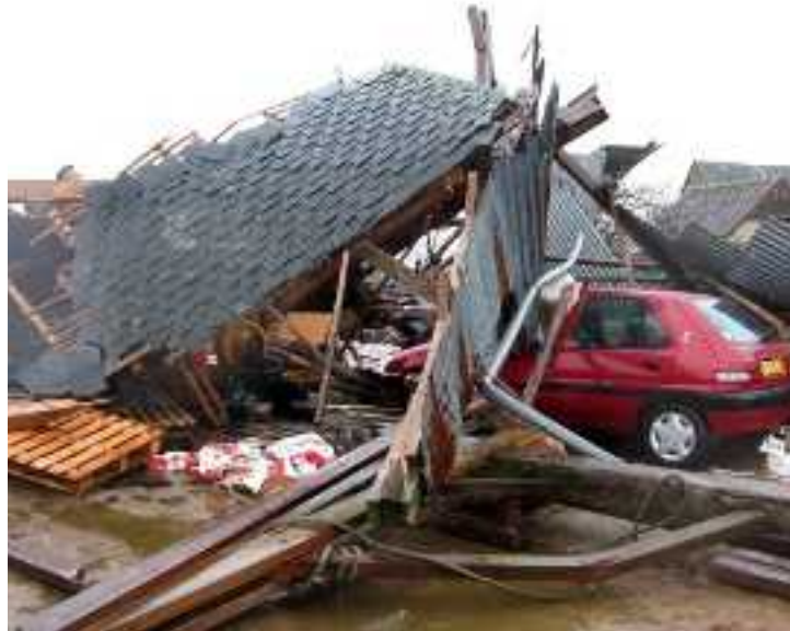
Le hangar s'est écroulé sur une voiture et une caravane.
